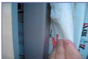
Рисунок 11. (подробнее) Установка оконного блока с обрамлением по откосу стальным профилем с последующим его утеплением
